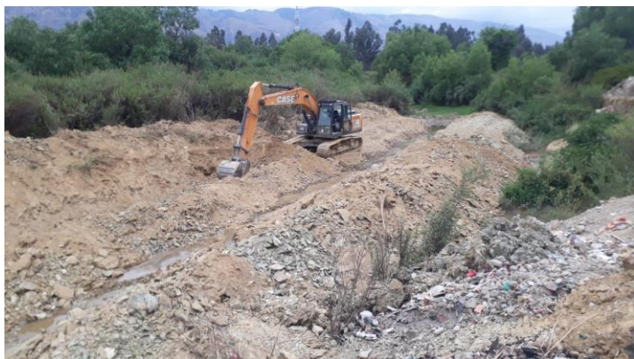
FOTO 9: Dragado con maquinaria pesada Rio Maylanco setor Esmeralda Sud aguas arriba del Distrito-4.
